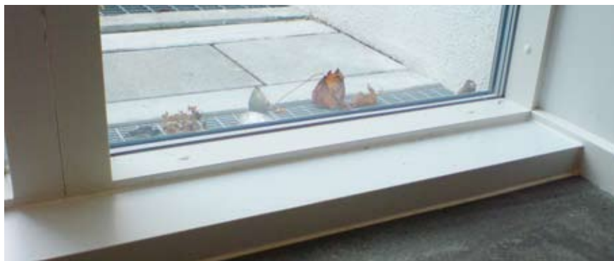
Nederkant fönster kan ge "kallhorn". Bilden visar kompletterande isolering mot nedre fönsterkarm för att minska köldbryggans effekt från fönster med sämre isolerad karm och kantbalk vid en passivhustillbyggnad av en befintlig skola. Passivhusskola i Hjörning, Danmark.
