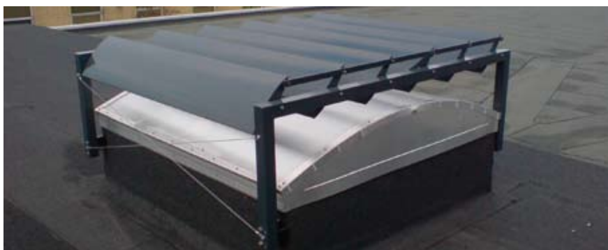
Fasta solskydd av takfönster till skolkorridor. Hjörning, Danmark.
